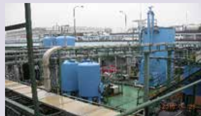
排水処理設備
